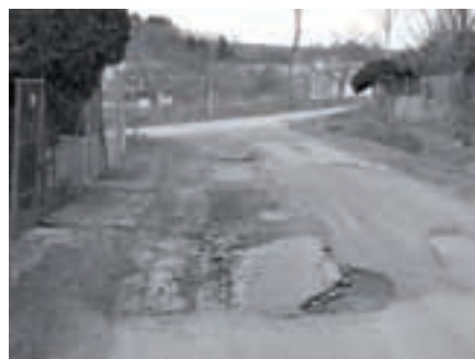
Tuhý mráz a rychlé tání poškodily povrch místních vozovek
